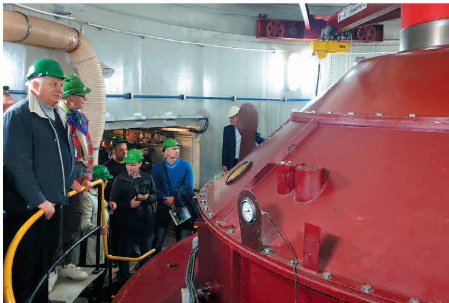
Šalia vieno iš Žarnovieco HAE hidroagregatų
