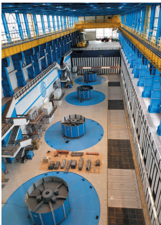
Žarnovieco HAE turbinų salė
